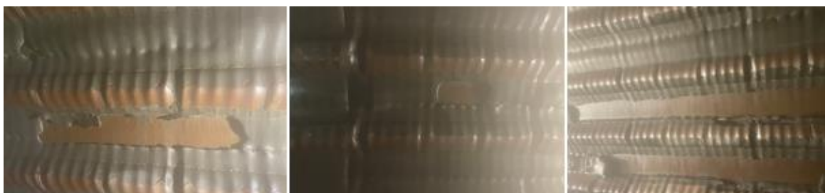
Figura 3.19 Condición interna del casco [Fuente: Mantenimiento Pucobre]
