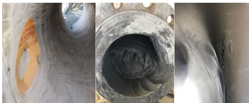
Figura 3.22 Condición interna de ductos [Fuente: Mantenimiento Pucobre]
