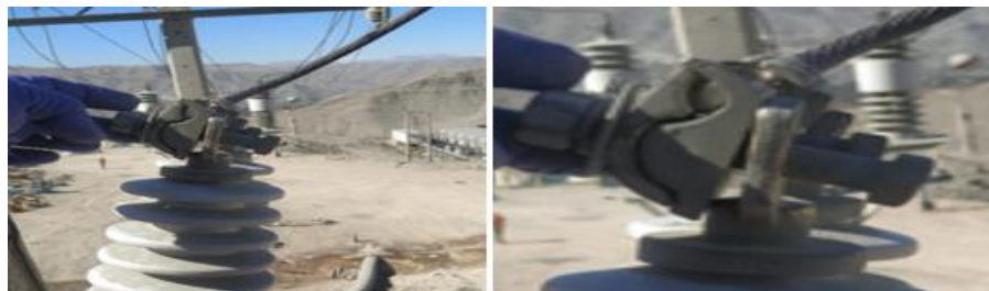
Figura 3.24 Mal montaje de prensa [Fuente: Mantenimiento Pucobre]
