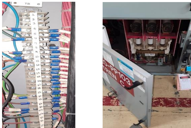
Figura n° 27 B: TB, bornera terminal del interruptor de media tensión.
