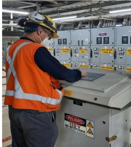
Figura n°26: Distancia para apertura (abrir) y cierre del interruptor(cerrar).
