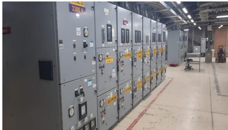
Figura n°4: Sala electrica de la planta concentradora.
