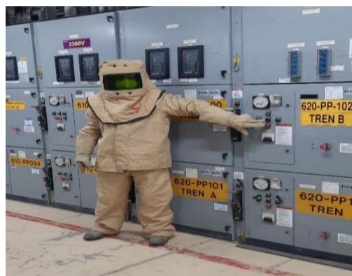
Figura nº 1: Maniobra desenergizacion de equipo de media tension según procedimiento interno.
