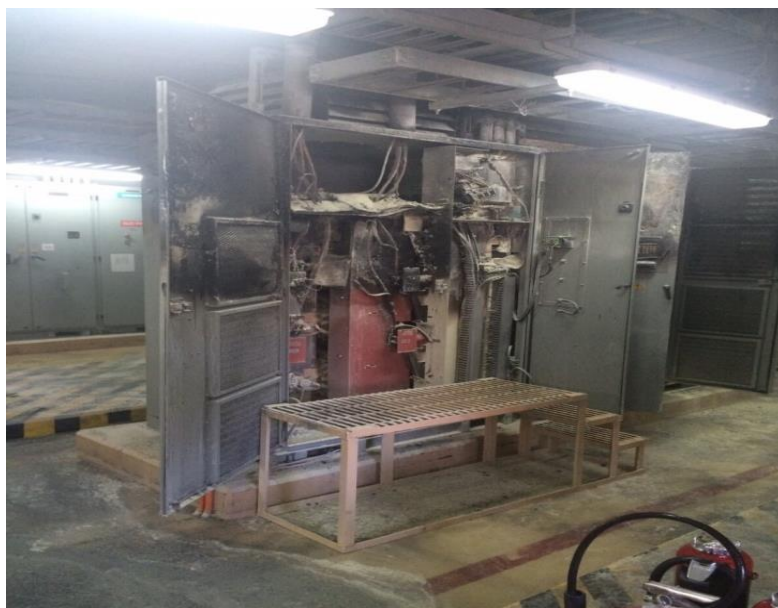
Figura N°31. Variador de Frecuencia TREN A siniestrado.
