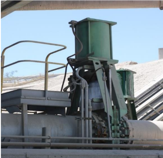
Figura N°17. Conjunto de válvulas de cuchillo de Tren C.
