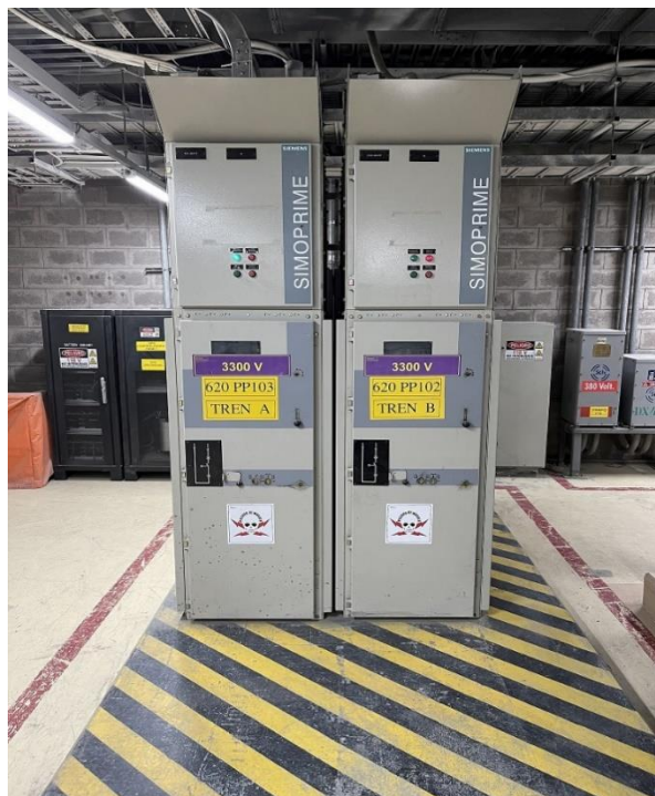
Figura N°37. Celdas Simoprime “A” y “B” instaladas y habilitadas.
