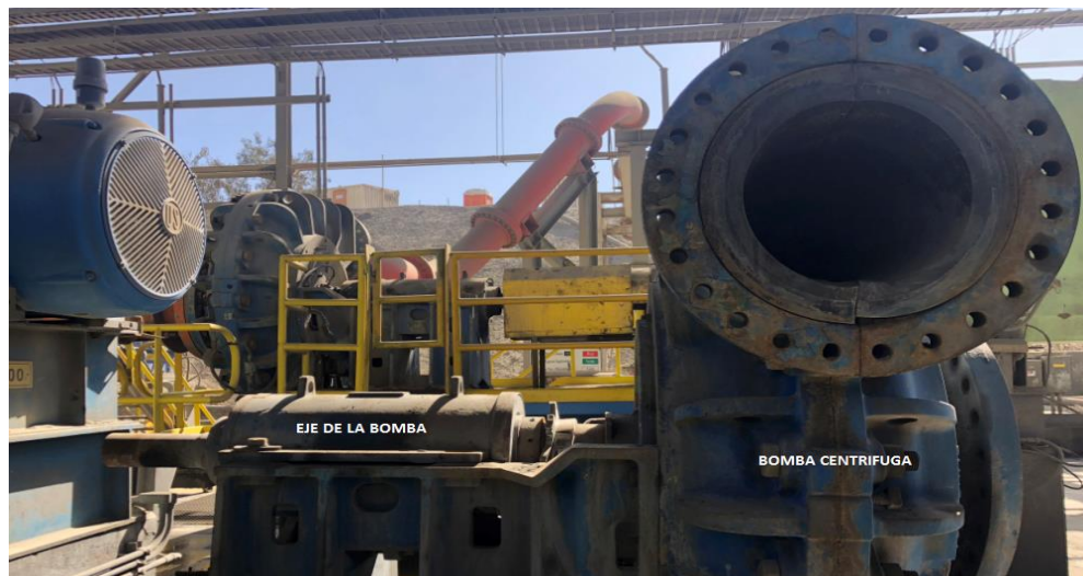
Figura N°15. Bomba Centrífuga Warman, acoplada a su eje.
