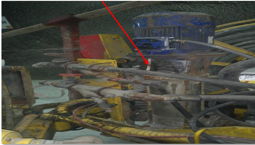
Figura 5.8 Bomba de agua
