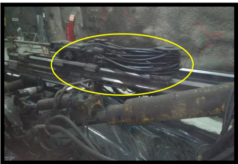
Figura 6.3 Flexibles fuera de medidas y pérdidas de aceite.
