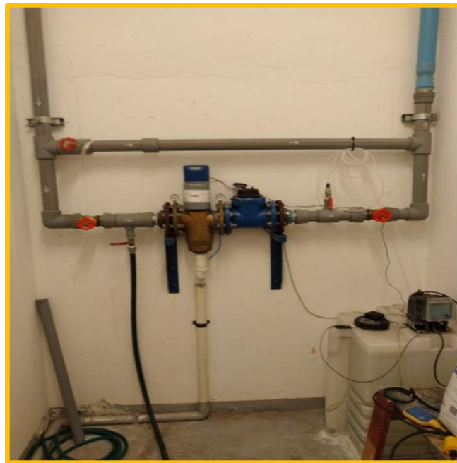
Fig. N°11, Filtro ablandador y su conexión.
