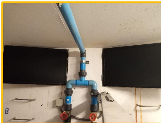
Fig. N°15, Estanques Acumuladores A (derecha) y B (izquierda).
