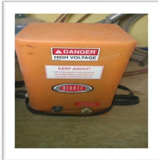
Figura N° 3.14: Modulo alta tensión.
