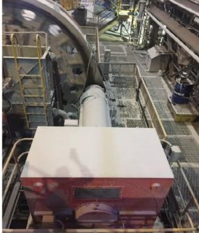
Figura 4. 7 Motores de molinos de barras de 497kw, 4.000 Voltios, 60Hz año de construcción 1957. Elaboración: Propia
