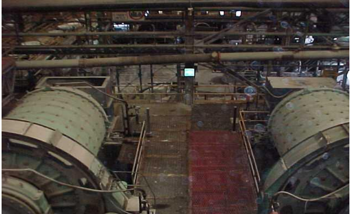
Figura 1. 3 Componentes de la Planta de Molienda Concentradora. Elaboración: Propia
