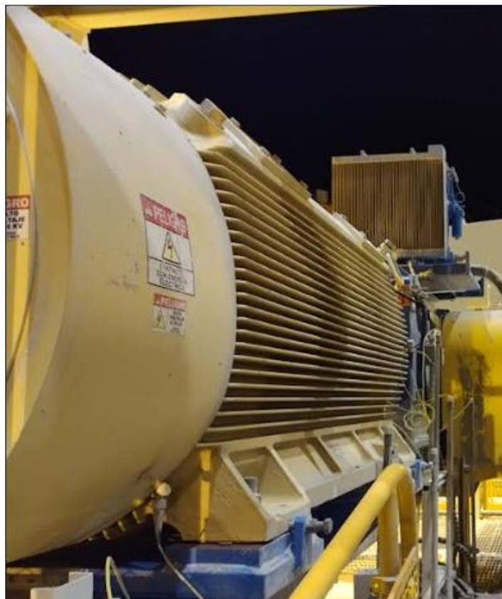
Figura N° 3.1: Vista real del motor de inducción existente.
