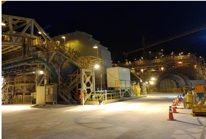
Figura N° B.2: Vista general alimentación molino SAG.
