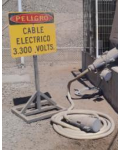
Figura N° 3.8: Cable minero de 8 kV.
