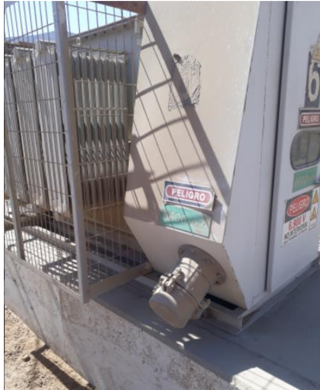
Figura N° 3.7: Transformador de 6.9 kV a 3,3 kV.
