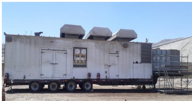
Figura N° 3.5: Motivator de 1500 kVA.
