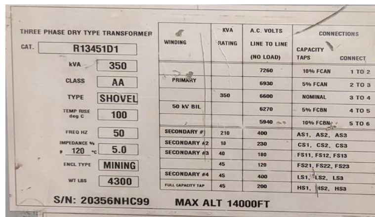
Figura N° 3.9: Placa de datos de un transformador de auxiliares de pala 4100A.
