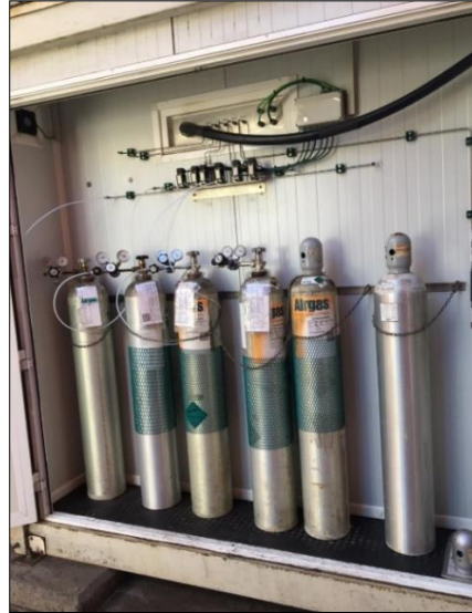
Figura N° 4.7: Compartimiento de gases cabina CEMS gases U4 Guacolda Energía.
