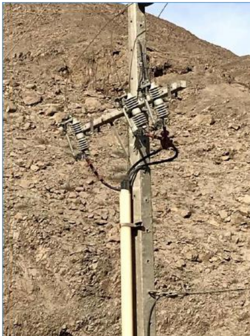
Figura N° 5.1: Empalme en MT con fusibles tipo hilo de 15 (A).
