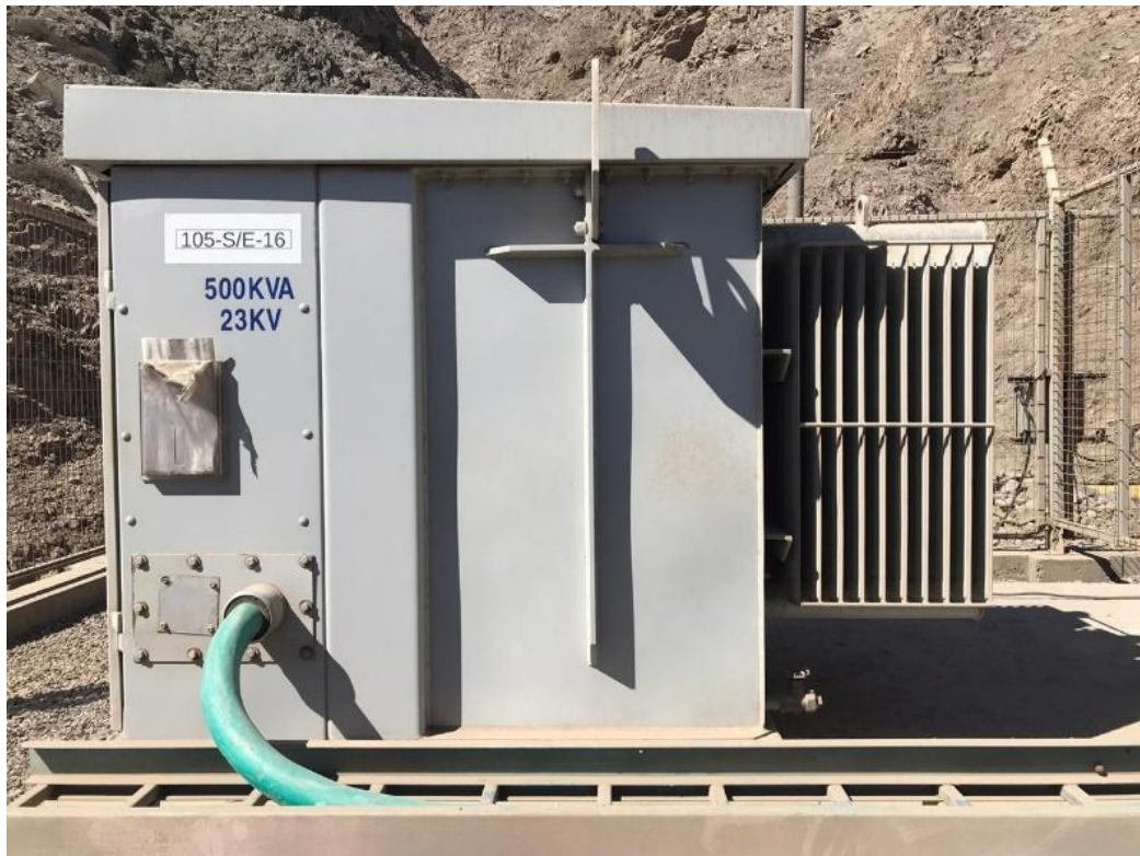
Figura N° 3.1: Transformador CH 500 kVA. Malaquita Sur.
