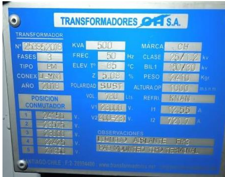
Figura N° 3.2: Placa característica de transformador instalado.
