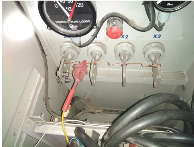
Figura N° 3.5: Bushings de BT cortocircuitados.
