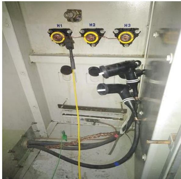
Figura N° 3.4: Bushings de AT cortocircuitados.
