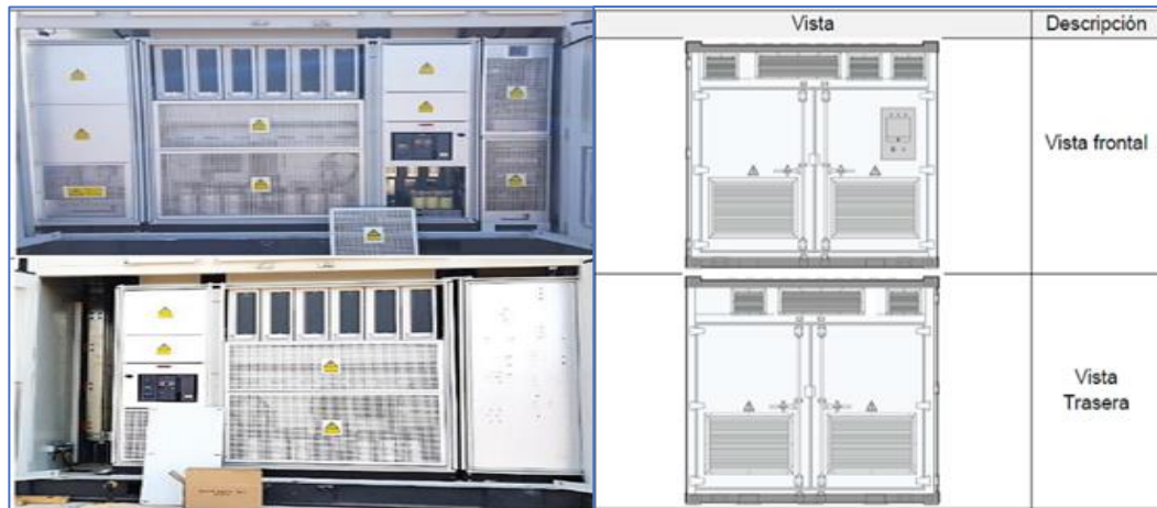
Figura 5.2: Vista general frontal y trasera del inversor.
