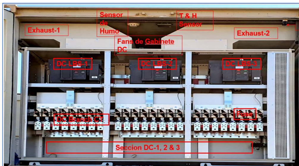
Figura 4.4: Inversor SG3125, conversión y fusibles DC.
