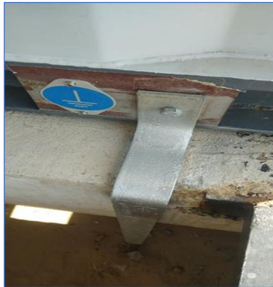
Figura 5.9: Toma puesta a tierra de la carcasa del inversor.
