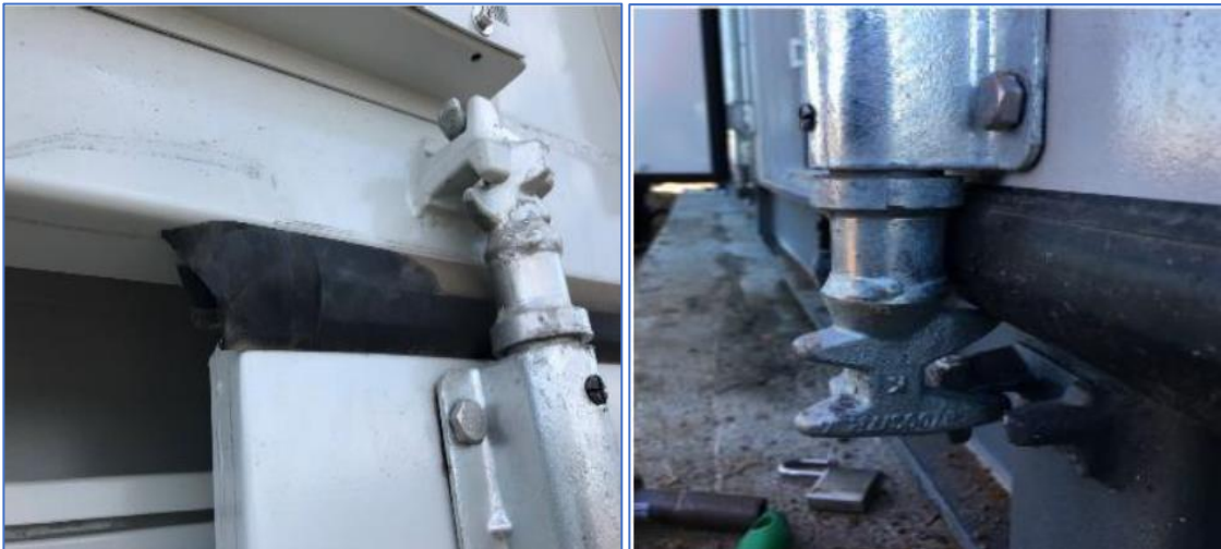
Figura 5.1: Apertura contenedor del Sungrow SG3125.
