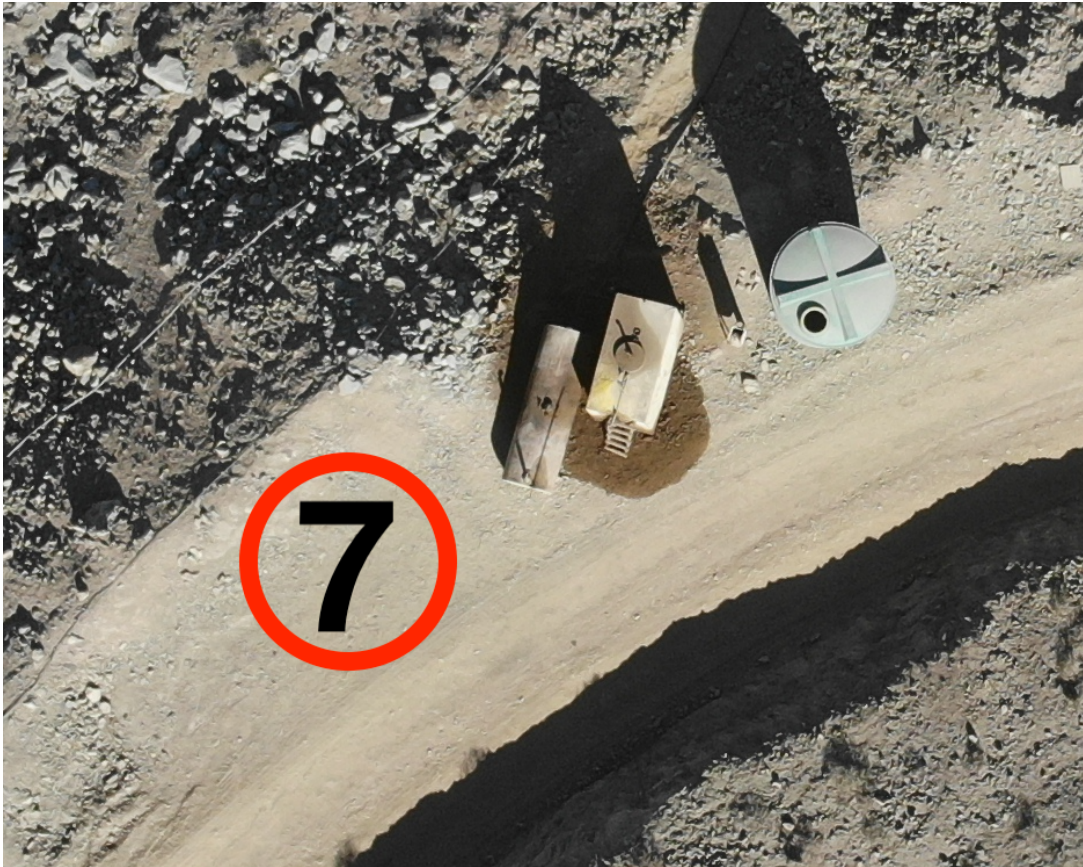
Imagen 10: Estanques de petróleo SOPLANA
