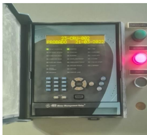
Figura N° 2.6: Relé de protección Multilin SR469
