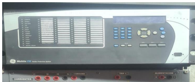
Figura N° 2.4: Relé de protección Multilin F 35.
