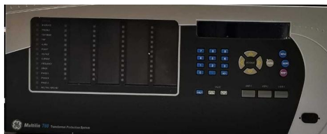
Figura N° 2.5: Relé de protección Multilin T 60.
