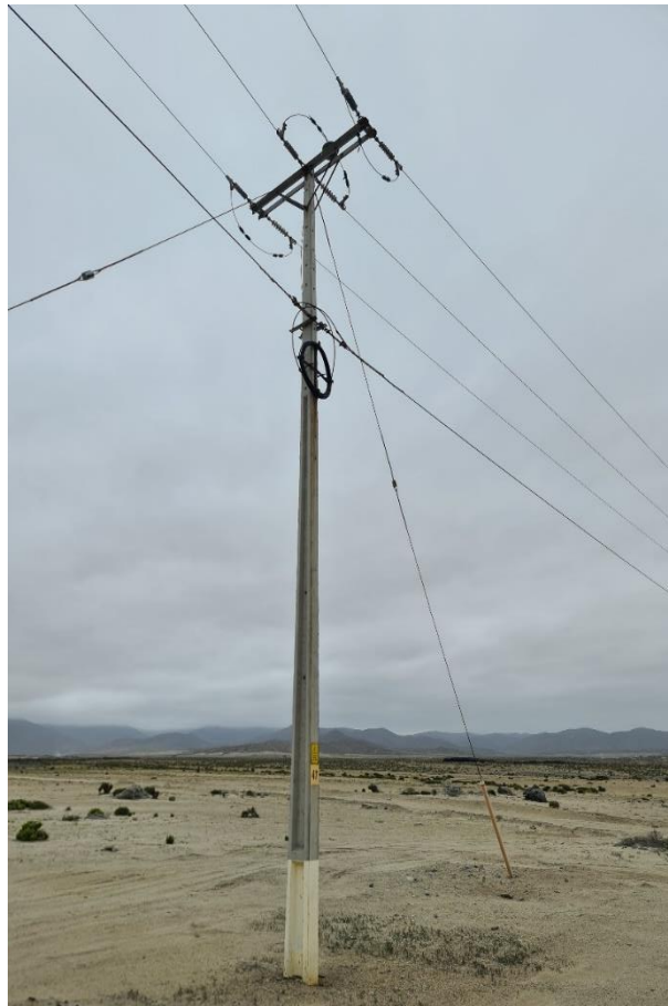
Figura N° 2. 12 Estructura de línea alimentación 23[Kv]
