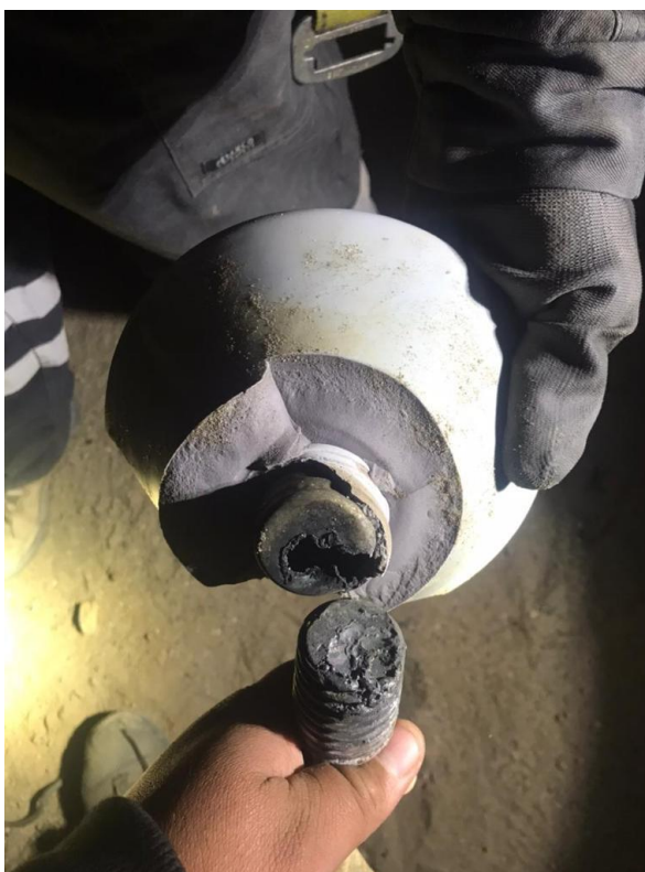
Figura N°3. 3 Falla de Aislador
