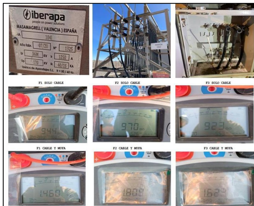
Figura 5.11 Registro de medida de resistencia de aislación cables MT.
