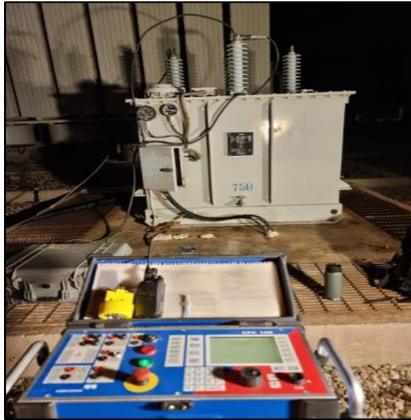
Figura 6.1 Pruebas con Ómicron CPC100 en transformador Zig-Zag.
