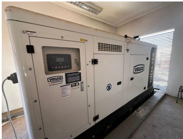
Ilustración 1. Generador eléctrico de la Sede Vallenar
