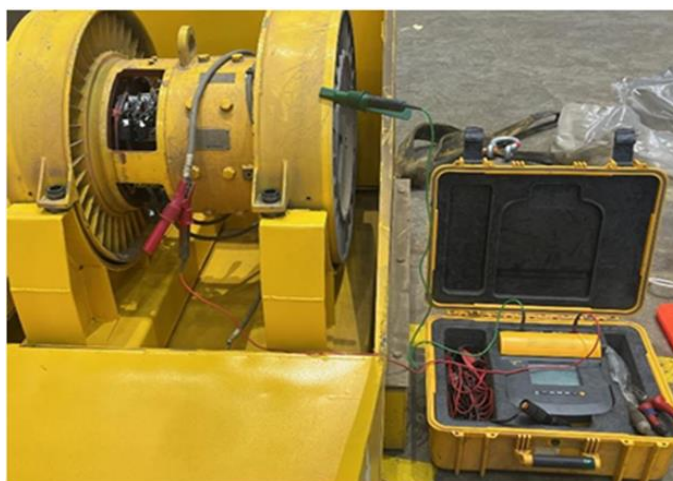
Figura N° 5.2: conexionado megohmetro a blower.
