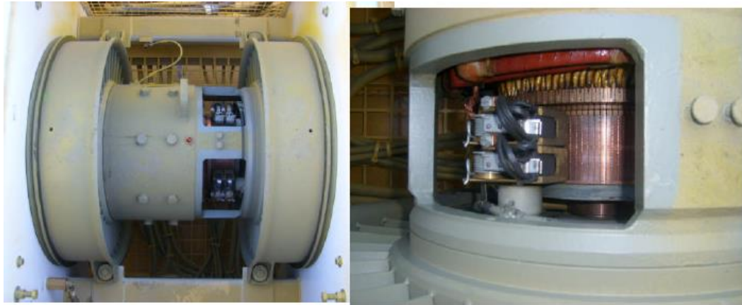
Figura N° 4.4: blower de ventilación.
