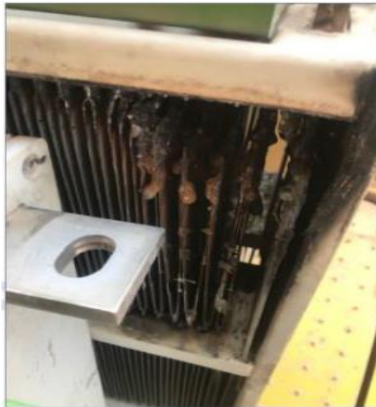
Figura N° 5.5: resistor dañado o en cortocircuito.
