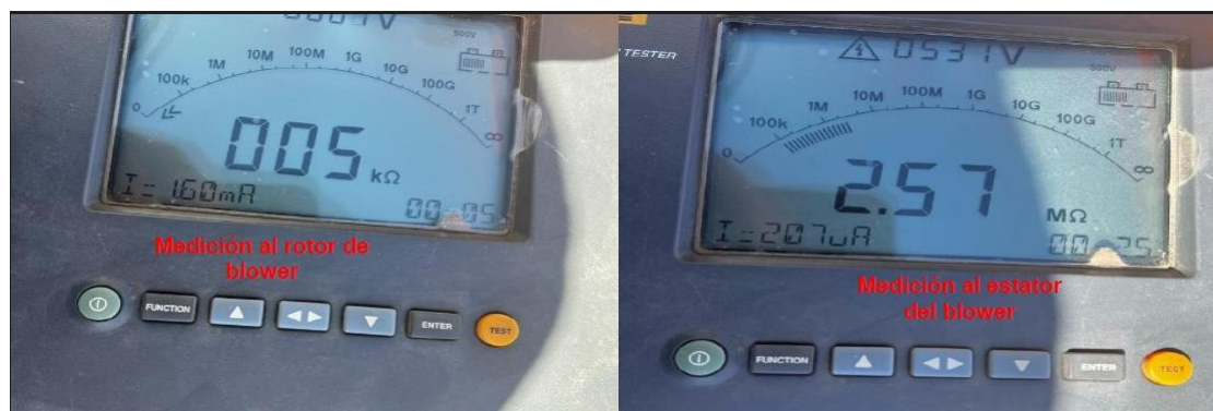
Figura N° 5.6: Medición de aislación de blower camión 830E – 1AC.
