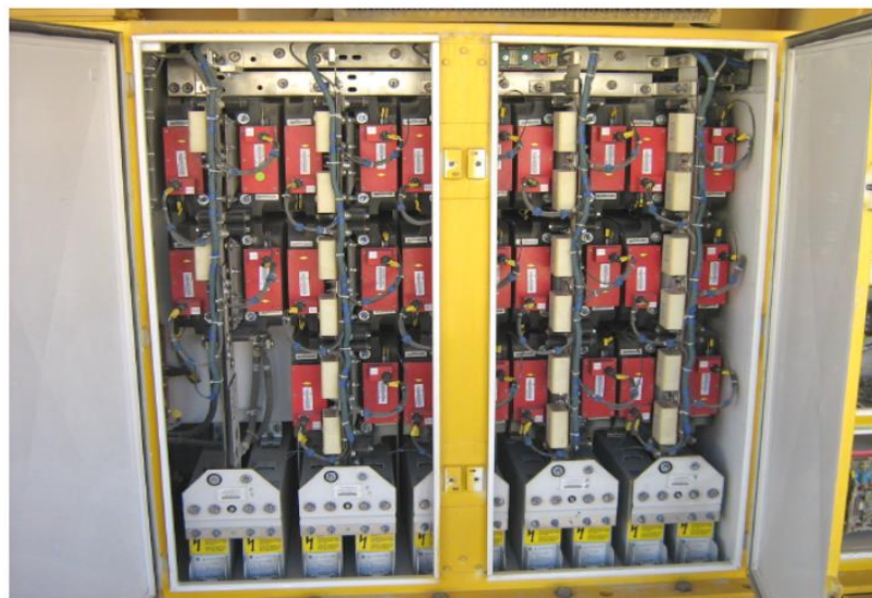
Figura N° 3.12: Gabinete de potencia con los módulos de disparo o IGBT.
