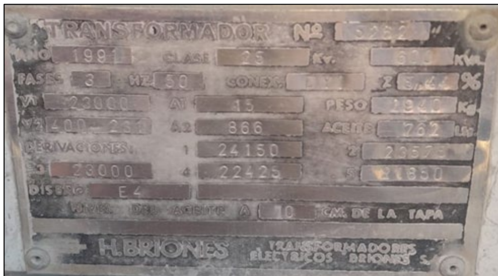
Figura N° 3.8 :Datos del transformador CCM 102, chancado fino.
