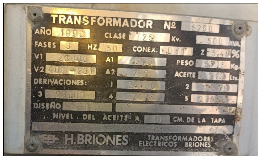
Figura N° 3.3: Datos placa transformador Chancado Primario
