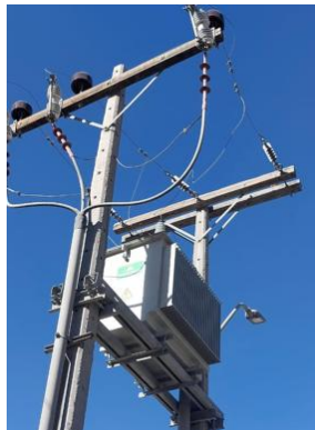
Figura N° 4.13: Transformador Rhona 400 KVA.
