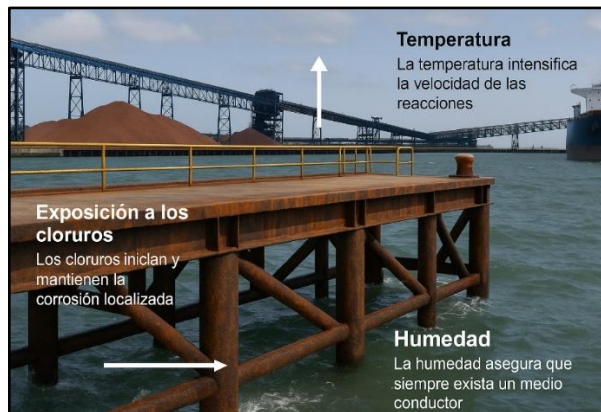
Figura 2.2 Imagen referencial de causas de corrosión
