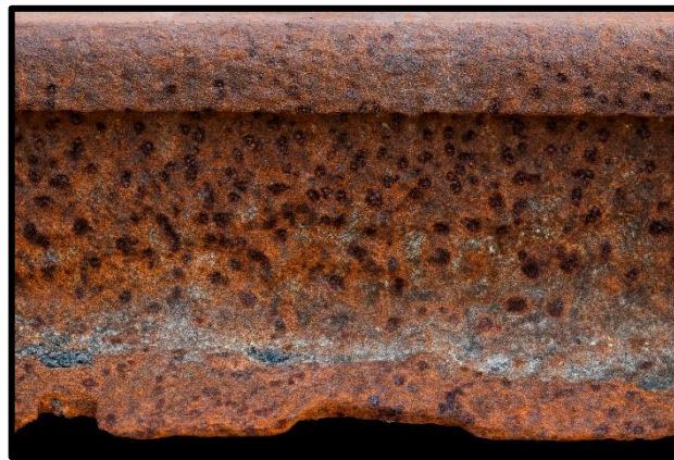
Figura 2.7 Corrosión por picadura
