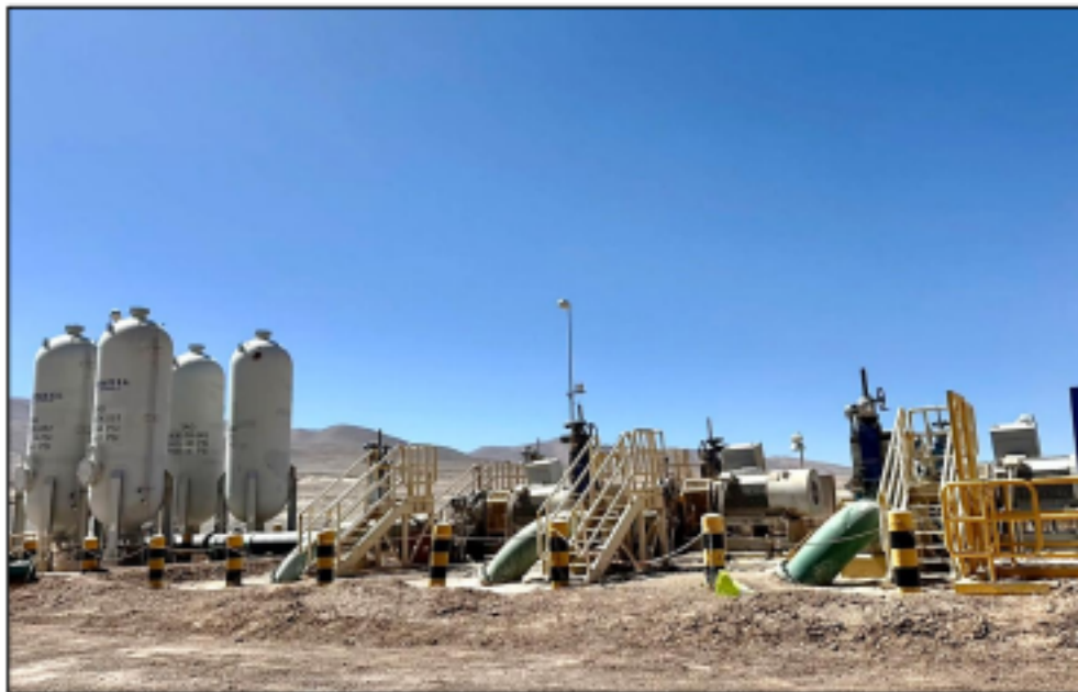
Figura 1.3 Estación de bombeo Booster 3.
