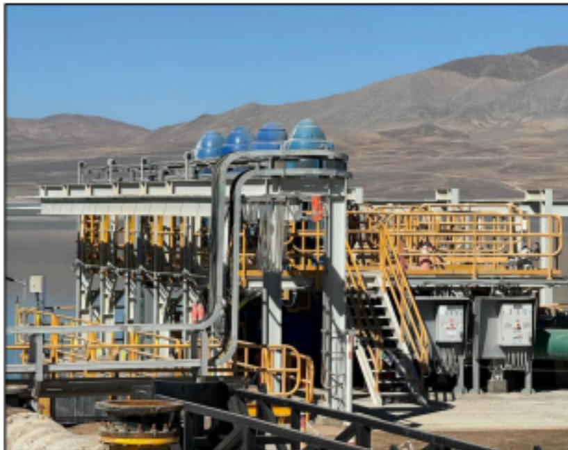
Figura 3.1 Bombas verticales torre de captación
