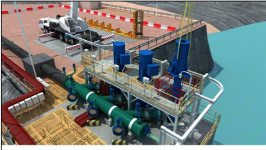
Figura 1.5 Bombas instaladas en torre de captación del tranque.
