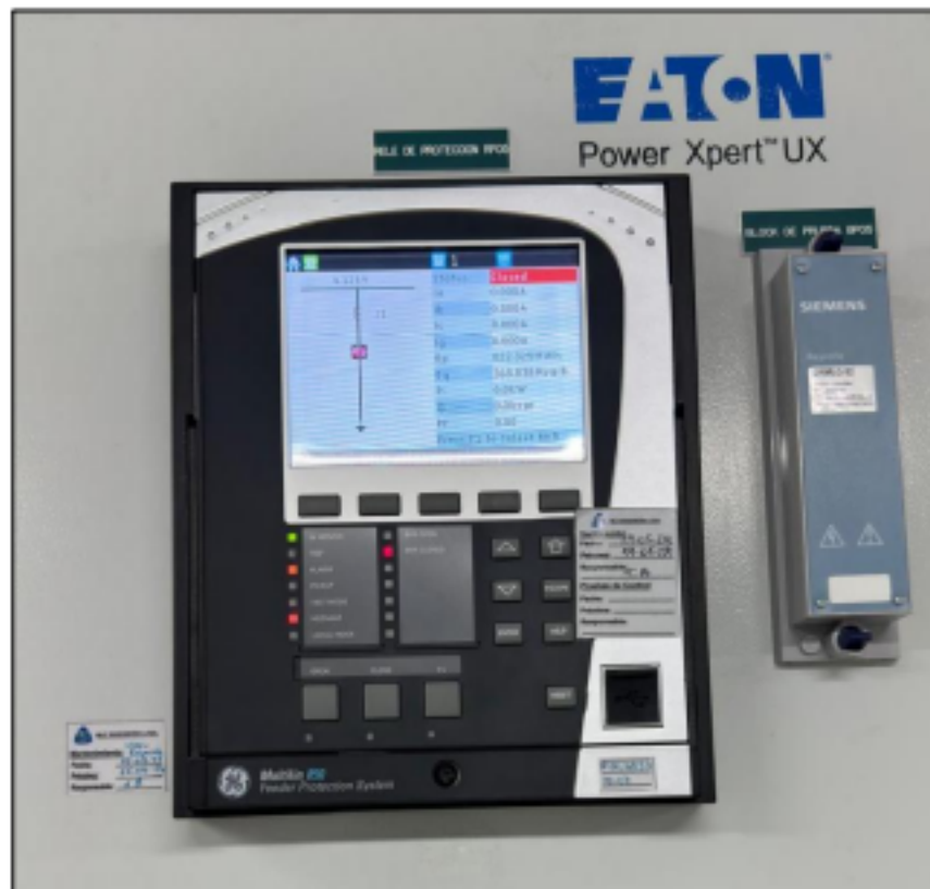
Figura 2.4 Relé de protección de motor multilin 850.
