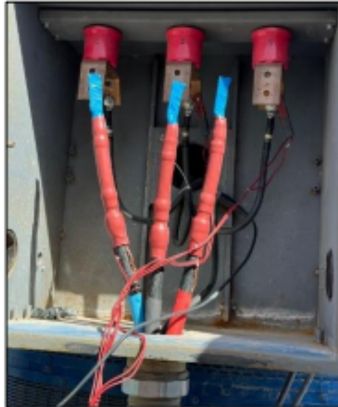
Figura 3.5 Desconexión motor 4,16Kv
