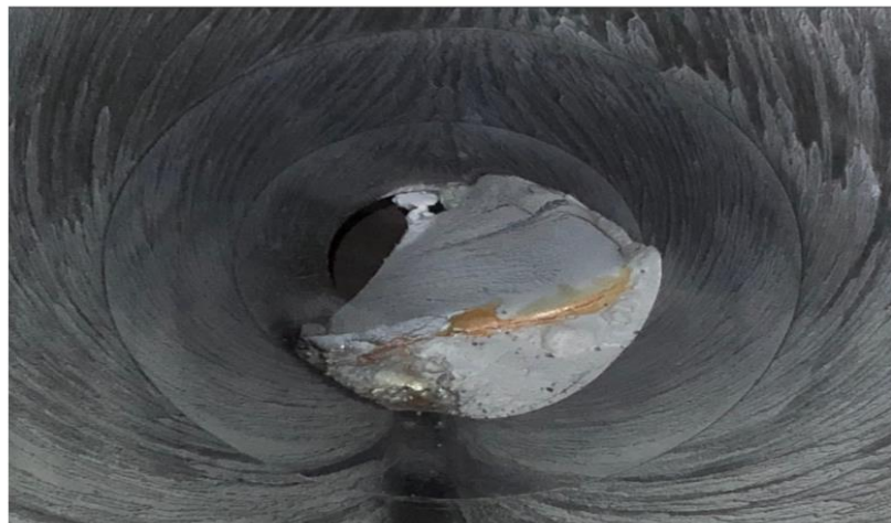
Figura N° 2.17: Obstrucción de apex por placa metálica externa.
