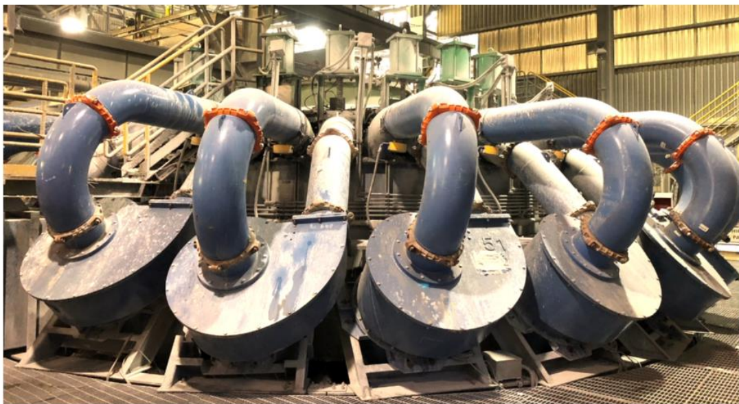
Figura N° 2.13: Imagen lateral de una batería de hidrociclones (configuración 45°)
