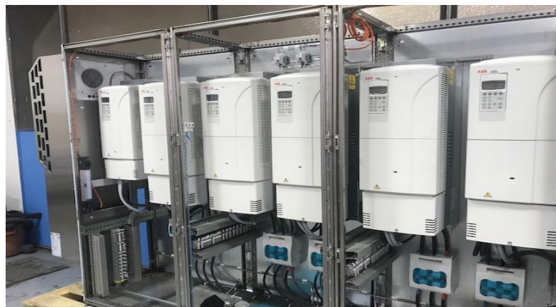
Figura N° 4.1 Gabinetes de variadores
