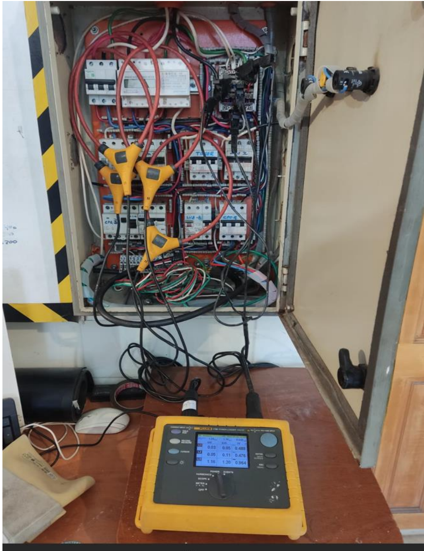
Figura N°3.2 Tablero General Trifásico Sattel Chile Ltda.
