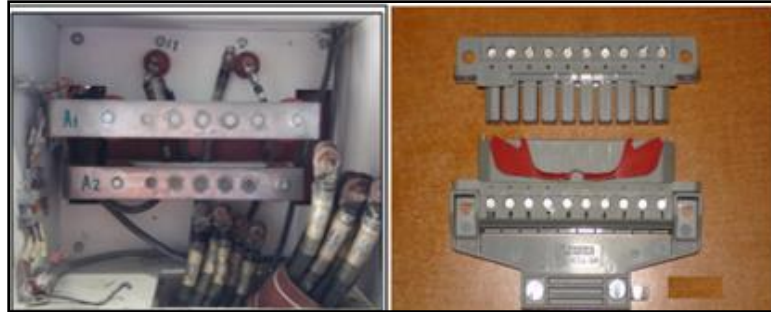
Figura N° 4.2: Regleta conexiones RTD, ubicada en la caja conexiones del motor.
