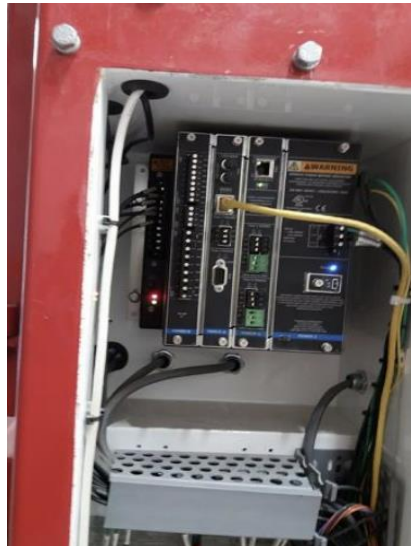
Figura 1.3. Montaje Físico Power Xpert 8000.
