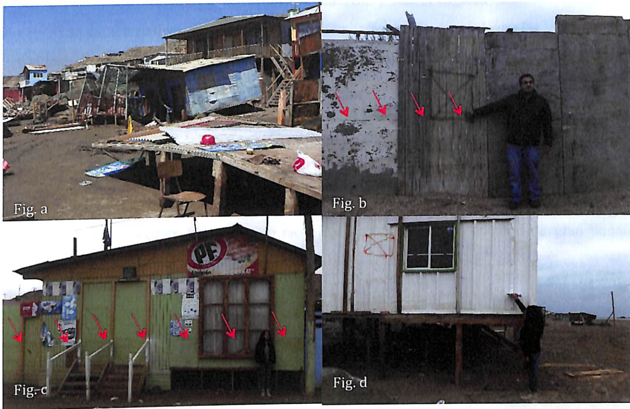
Figura 5.12. a. Consecuencia del tsunami. b, c, y d mediciones en terreno del nivel de inundación en las construcciones.
