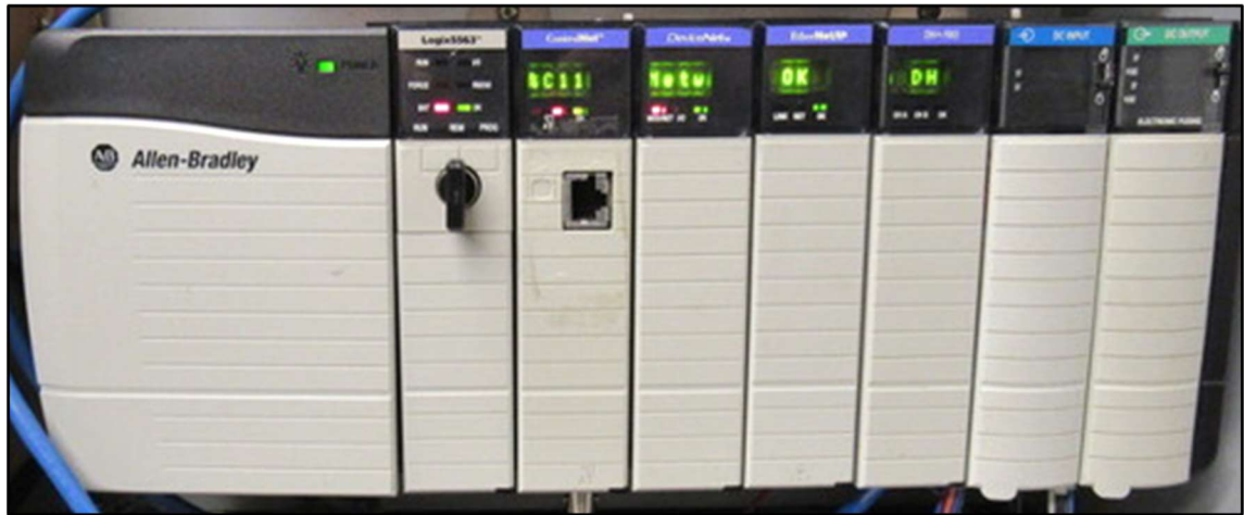
Figura. N° 2.9. PLC Allen-Bradley Control Logix
