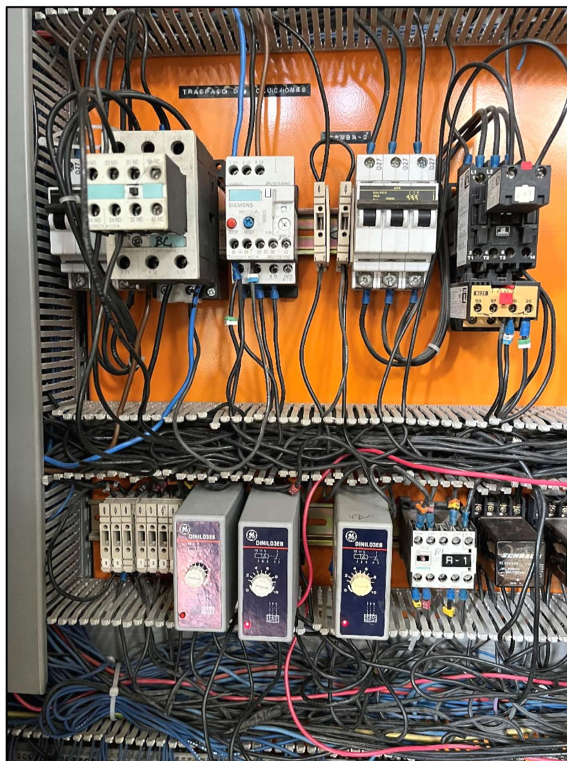
Figura. N°3.7 Actual Tablero de control FEF #2
