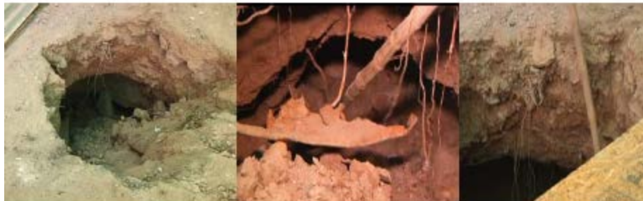
Figura N° 3: Imágenes de la subsidencia en patio de una casa, calle Manuel Montt 445 b, comuna de Tierra Amarilla. Poseía un diámetro de 1.5m con 4m de profundidad
