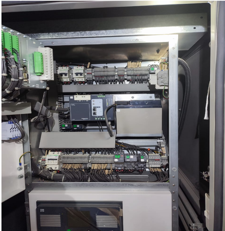
Figura N° 3.5: Conexiones switchgear nivel 430.
