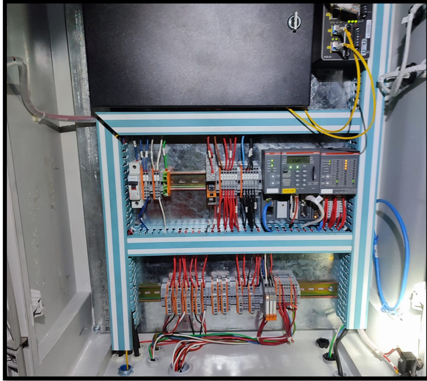
Figura N° 4.18: Conexiones de control en tablero PLC.
