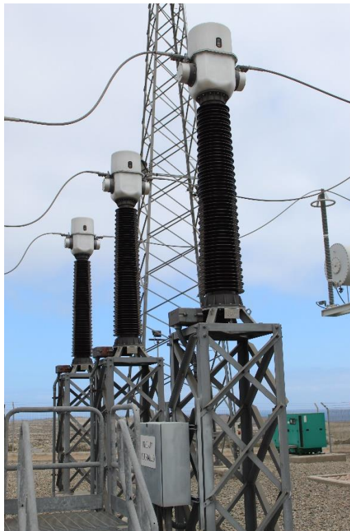
Fig 4.4: Transformador de corriente (TC)
