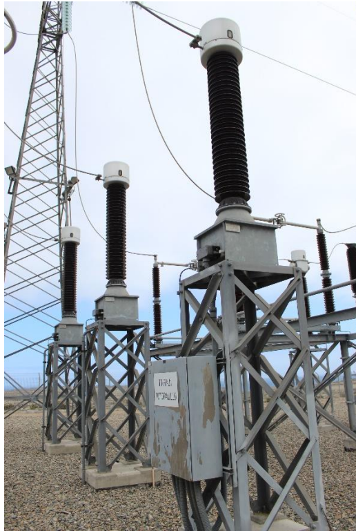
Fig 4.5: Transformador de potencial (TP)
