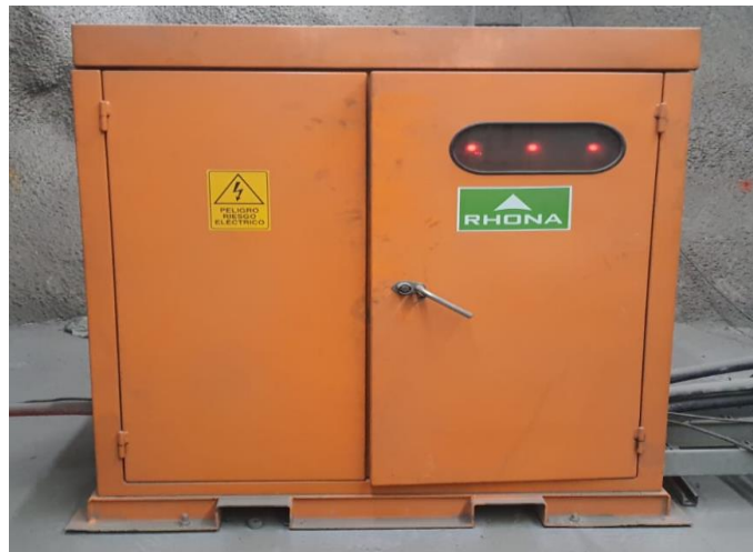
Figura N°3.1: Subestación eléctrica de 1000 KVA.
