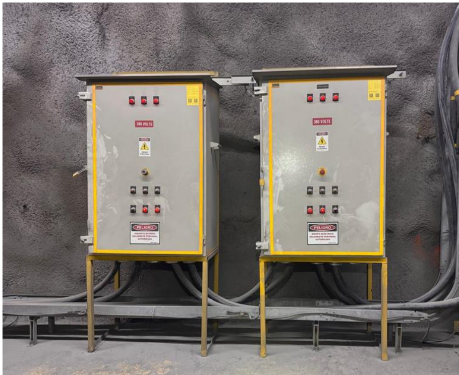
Figura N°4.8: TDB instalados según estándar implementado por Candelaria UG.
