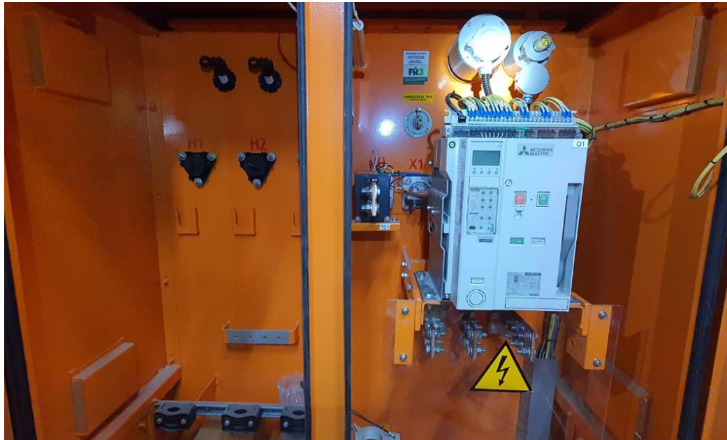
Figura N°3.10: Subestación de 1000KVA, del fabricante “Rhona” dispuesta a realizar pruebas de comisionamiento.
