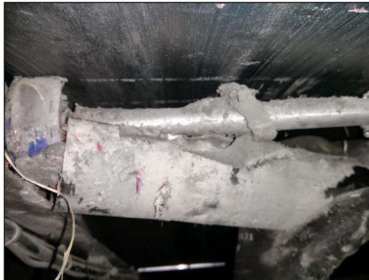
Figura N°3.7: Desgaste de estructura.
