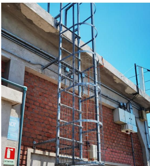
Figura N° 5.2: Escalera tipo gato (Vertical fija).
