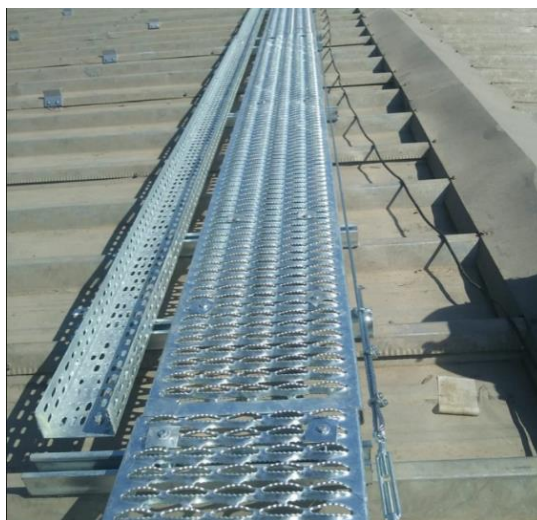
Figura N° 5.1: Pasillo técnico y línea de vida.
