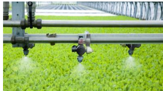
Figura 2. 11: Riego por microaspersión Desplazamiento
