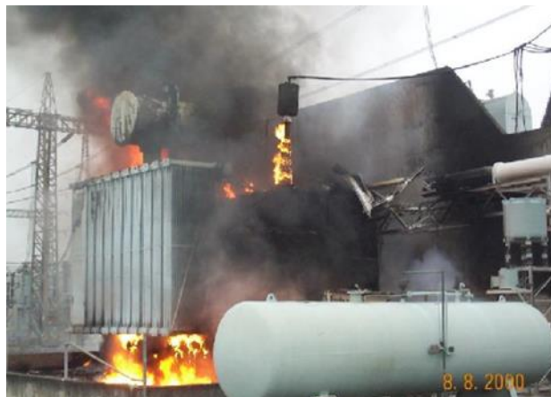
Figura 1.2. Falla e Incendio en Transformador de Poder
