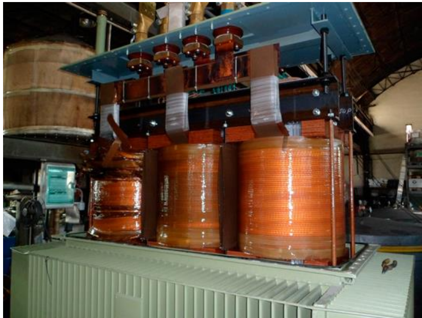
Figura 3.6. Transformador en falla de devanado retirado desde cuba.
