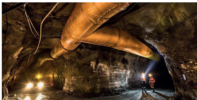
Ilustración 2. 3 Mangas de ventilación mina subterránea
