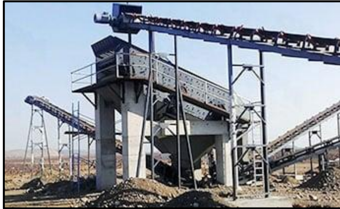
Figura N°7 Vista general de línea de trituración de mineral de cobre.
