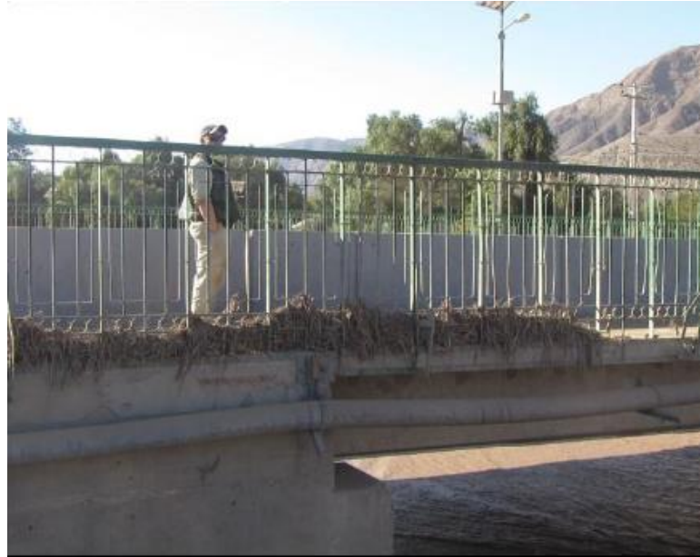
Figura 93: Puente Calle Ojancos (Rotonda Cristo). En la calzada del puente se observa la presencia de ramas y barro como evidencia del desborde en este punto. Extraído de SERNAGEOMIN (2017).
