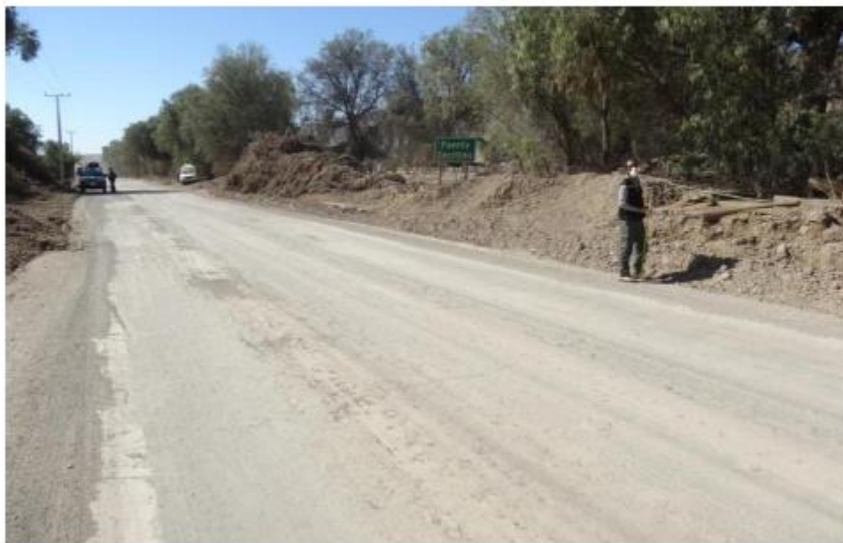
Figura 83: Sector Puente Cerrillos (zona de confluencia) de la ruta C-35. Se observa material detrítico y árboles apilados al margen de la carretera, provenientes de la quebrada Carrizalillo y del cauce del río lo que generó el entrapamiento de materiales. Extraído de SERNAGEOMIN (2015).
