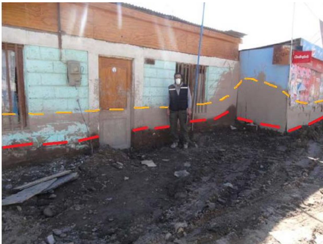
Figura 87: Casa afectada por la inundación en el sector Punta de Bateas en donde se distinguen dos marcas; línea segmentada color naranja indica la altura más alta de inundación y de color rojo (debajo), indica la altura del depósito. Extraído y modificado de SERNAGEOMIN (2015).
