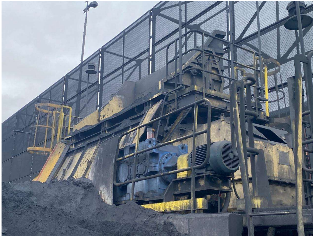
Figura N° 2.12 Alimentador de banda.
