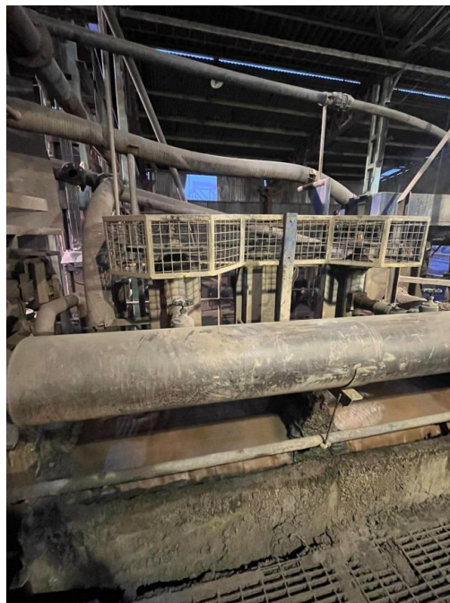
Figura 2.10. Celdas Cleaner circuito principal Planta ENAMI Vallenar
