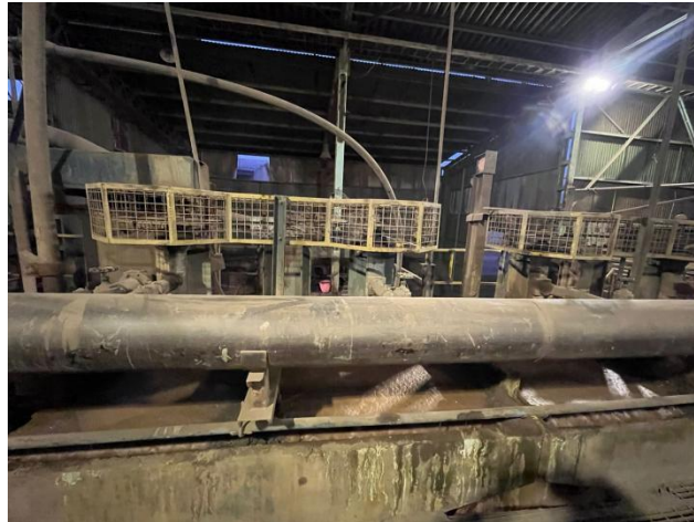
Figura 2.9. Celdas Rougher circuito principal Planta ENAMI Vallenar
