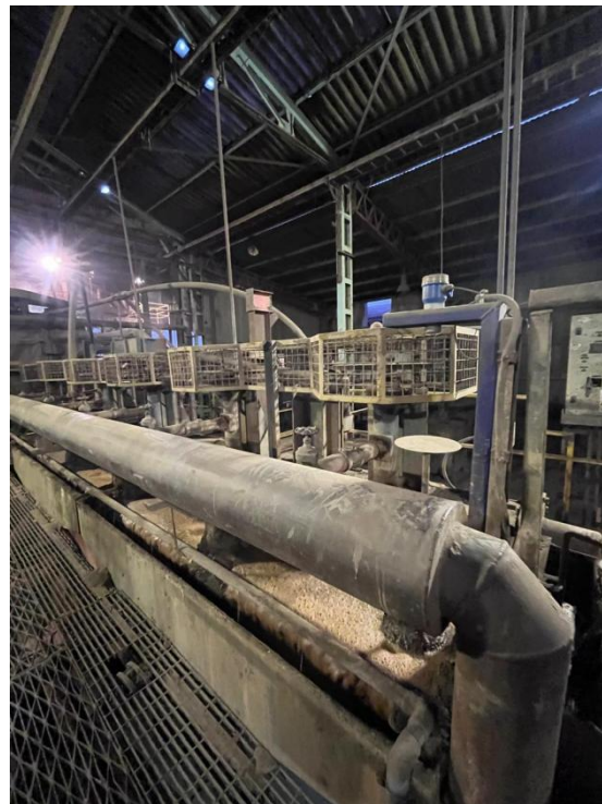
Figura 2.12. Celdas Scavenger circuito principal Planta ENAMI Vallenar
