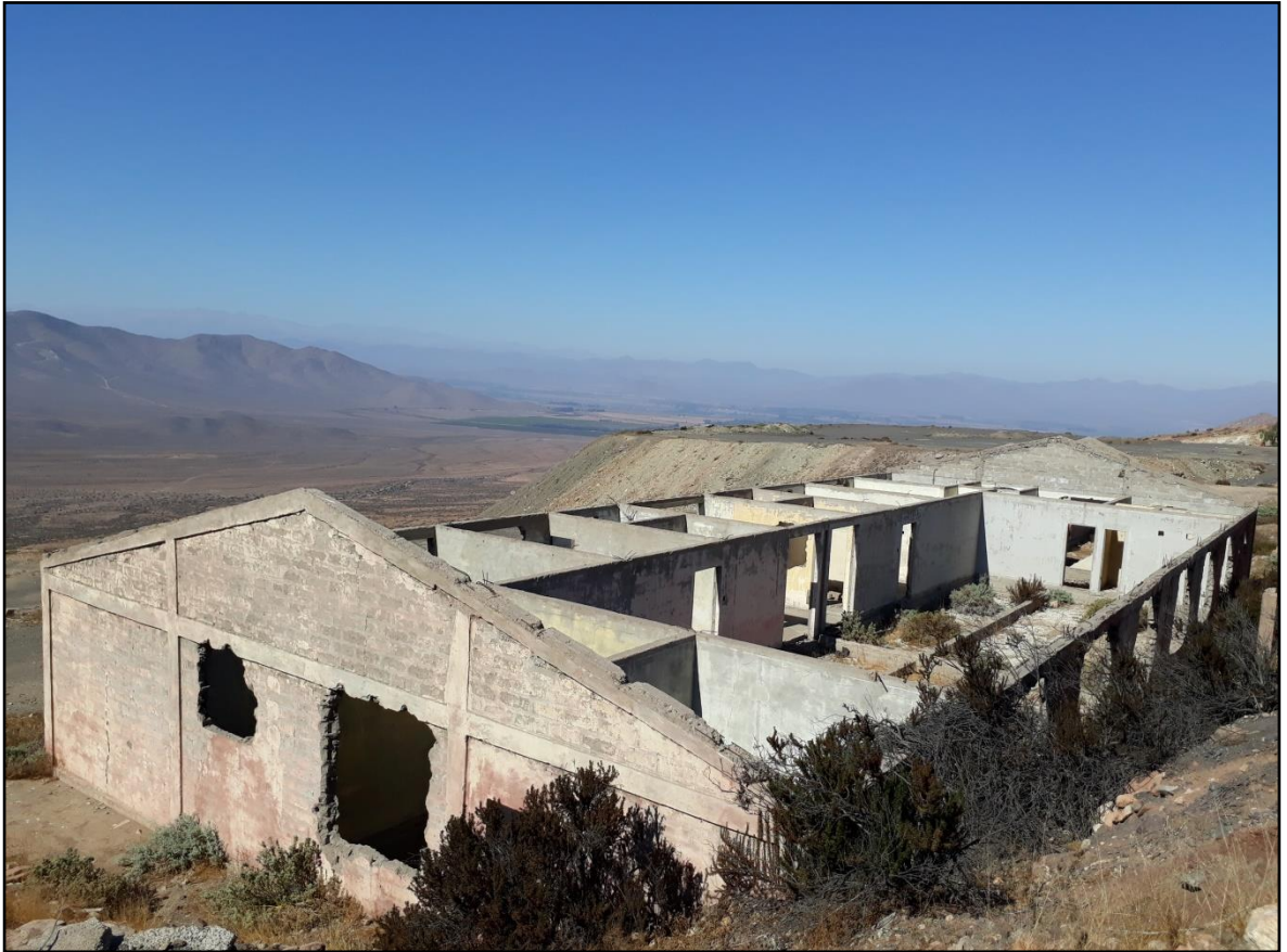
Figura 4.17 Fotografía tomada de “La Casona”. Se pueden observar las diferentes divisiones que esta presenta, por lo que se infiere que pueda ser una oficina o la casa habitada por el administrador de la mina.
