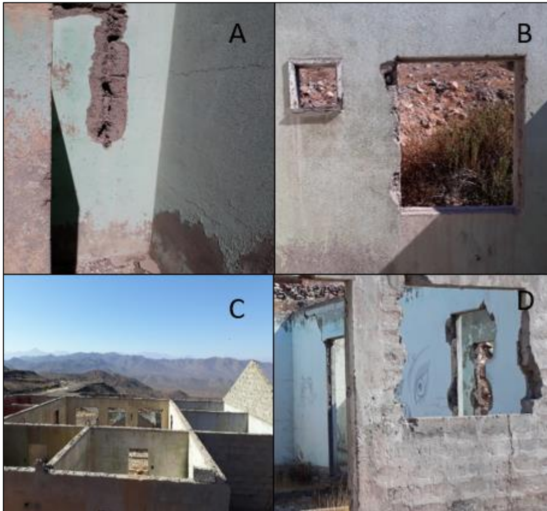
Figura 4.15 Fotografías tomadas para el registro del daño a infraestructuras. A) se observa la marca en la pared al sacar las cañerías de un baño. B) los marcos de ventanas de madera desprendidos. Originalmente eran como se observa en la ventana más pequeña. C) Destrucción de techumbre. D) en las paredes hay dibujos realizados posiblemente por personas que han pasado por el lugar.
