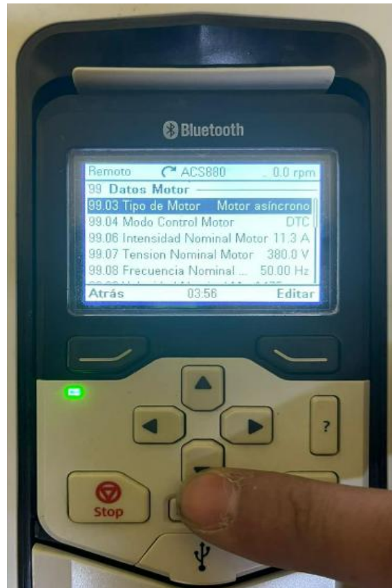
Figura N° 6.4: Configuración de variador de frecuencia.
