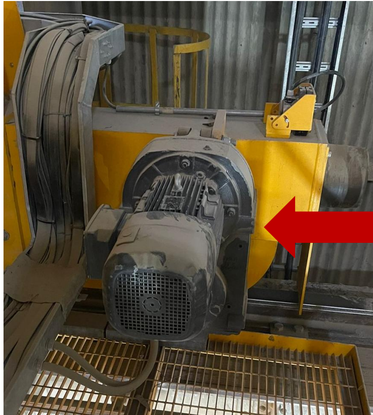
Figura N° 7.3: Moto reductor trifásico.
