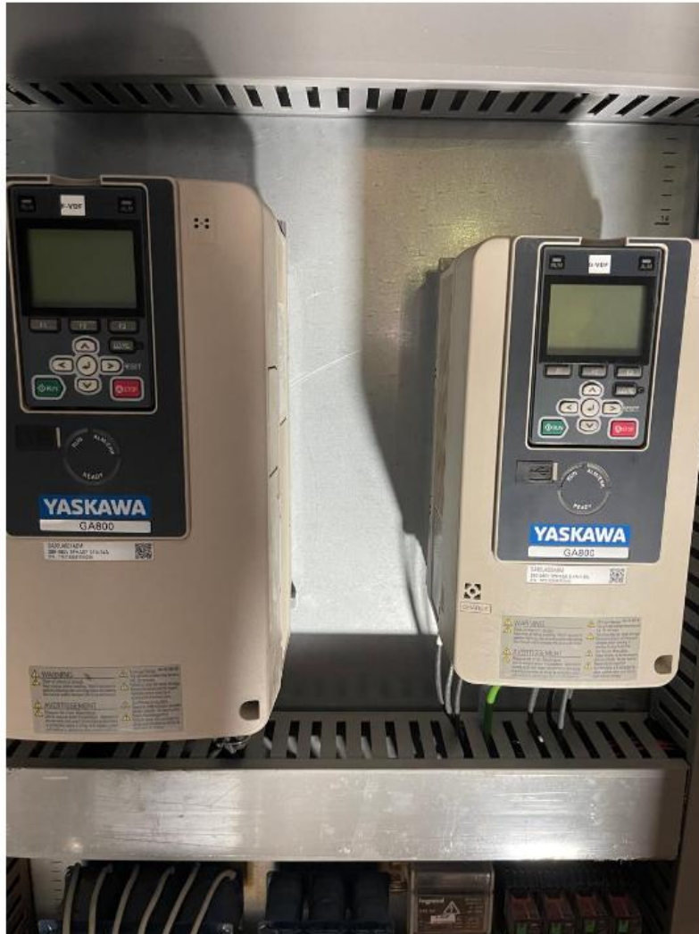
Figura N° 7.8: Variador de frecuencia para carro y traslación de puente grúa.
