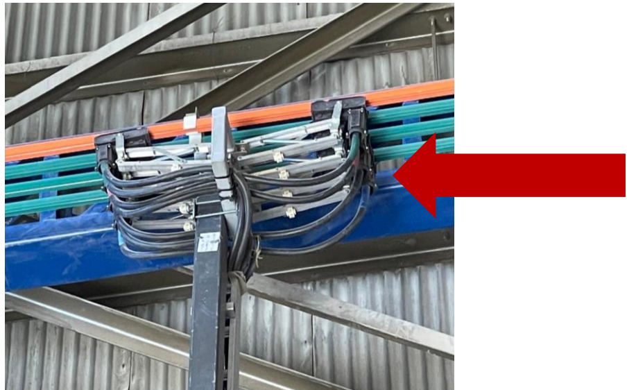
Figura N° 7.1: Sistema de barras conductoras de electrificación.
