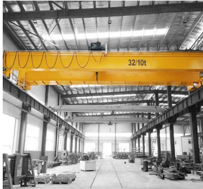
Figura N° 2.1: Puente grúa monorriel de 32 t.
