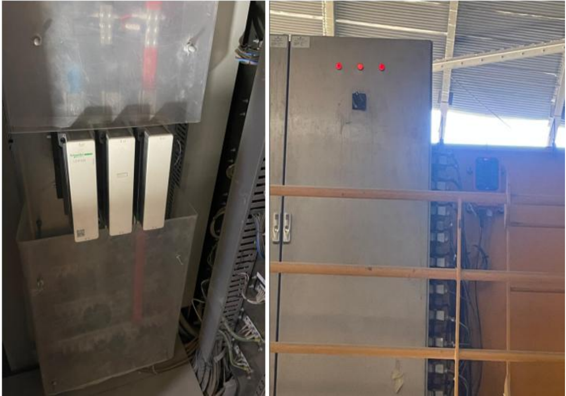
Figura N° 7.5: Gabinete de control y fuerza instalado en puente grúa.
