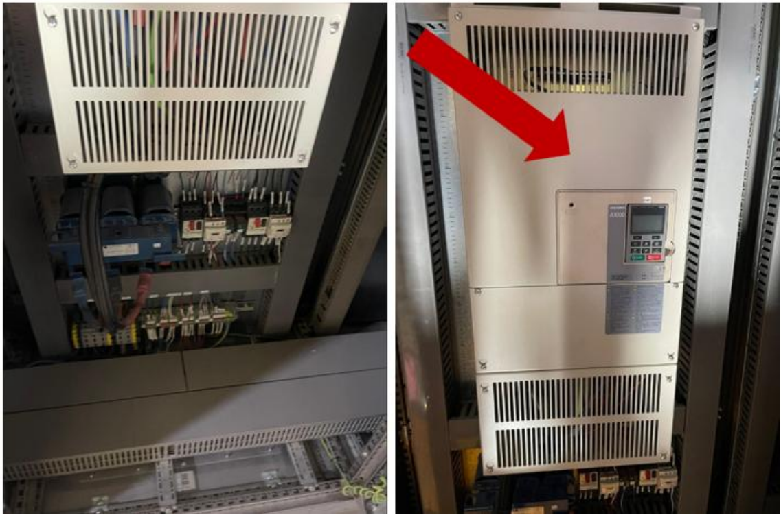
Figura N° 7.4: Variador de frecuencia gancho principal.
