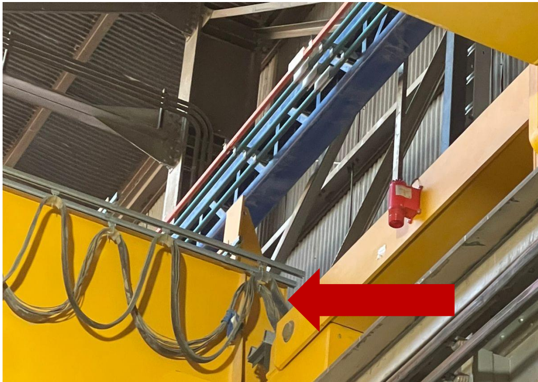
Figura N° 7.2: Canalización de conductores tipo Festoon.
