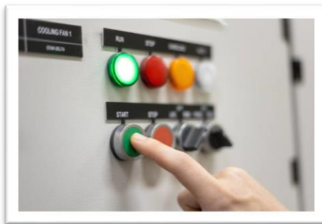
Figura N°2.27: Operación de forma Local.
