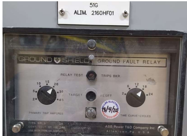
Figura N° 3.2: Relé de protección análogo para fallas a tierra.
