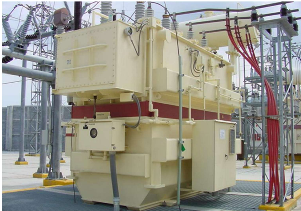
Figura N° 1.3: Transformador de potencia.
