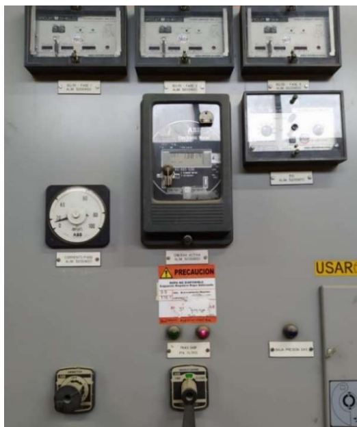
Figura N° 3.3: Equipos de protección análogos en funcionamiento
