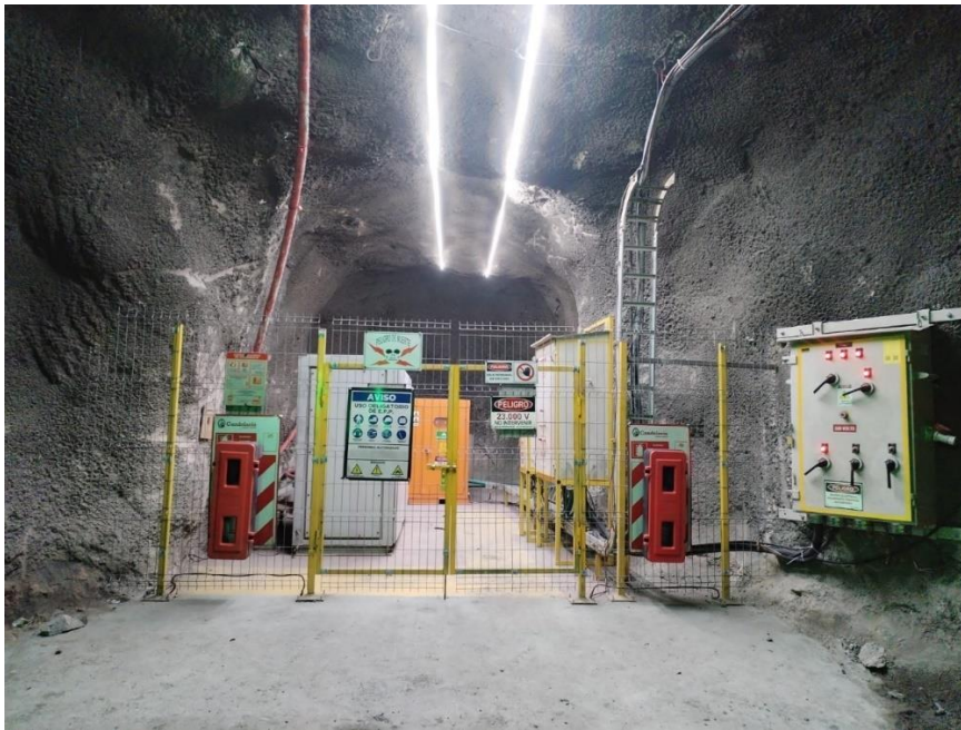
Figura N°3.12: Imagen recinto de S/E y SWG interior Mina Alcaparrosa
