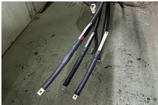
Figura N°4.5: Mufa de terminación en MT
