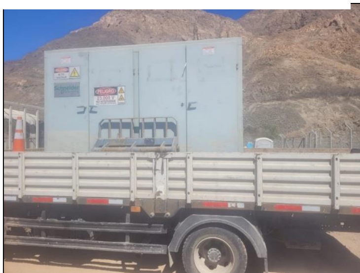
Figura N° 3.11: SWG cargado en camión 3/4
