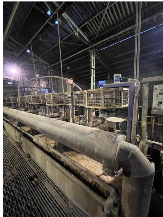
Figura 2.12. Celdas Scavenger circuito principal Planta ENAMI Vallenar
