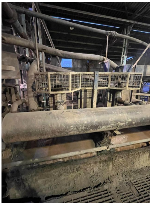
Figura 2.10. Celdas Cleaner circuito principal Planta ENAMI Vallenar
