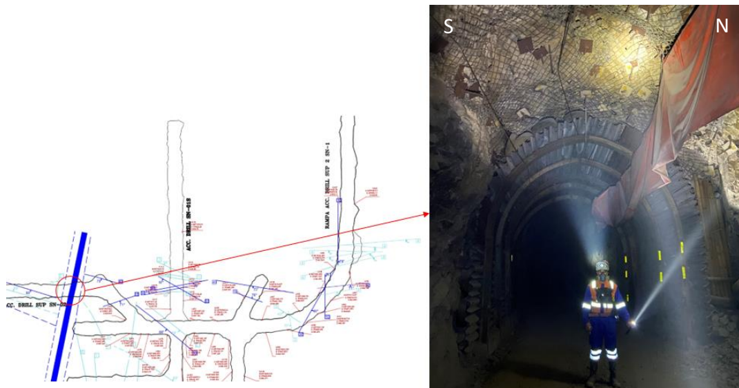
Figura 5.14: En la foto de la derecha se aprecia la fortificación de la labor en el nivel 450 debido al daño en la roca generado por la interacción entre la Falla B y J, lo que disminuyó considerablemente la calidad de la roca (Elaboración propia).
