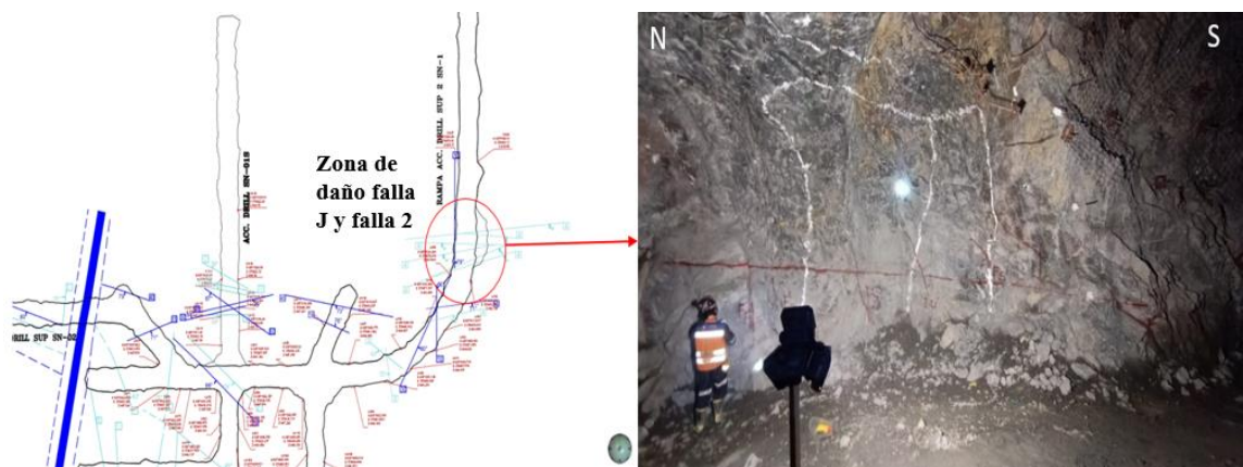
Figura 5.12: A la derecha se aprecia una foto de la zona de daño en la roca de caja, provocado por el conjunto de fallas menores derivadas de la interacción entre las fallas J y 2 en la rampa de acceso al nivel 450 indicado en rojo en la imagen de la izquierda (Elaboración propia).
